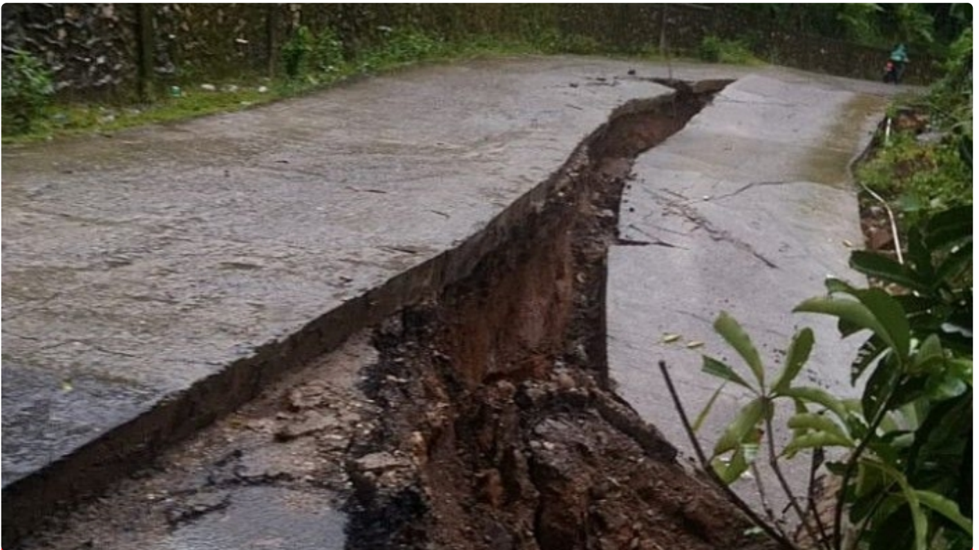
Akses Jalan Poros longsor, Kendaraan Warga Tondong Tallasa Tidak Bisa Lewat Lagi di Desa Malaka
